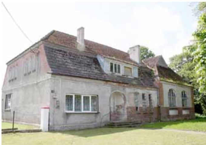
Budynek obecnej świetlicy - w stanie katastrofalnym
